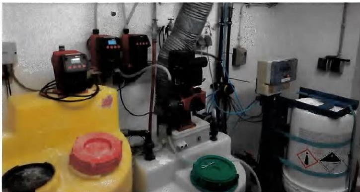
Abbildung 3 Die neue Chlorpumpensteuerung im Freibad Fladungen (Foto: Stadt Fladungen).
