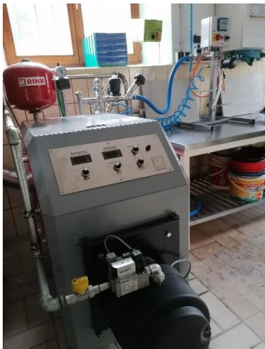
Abbildung 11 Die neue Pasteur- und Abfüllanlage (Foto: OGV Mellrichstadt).
