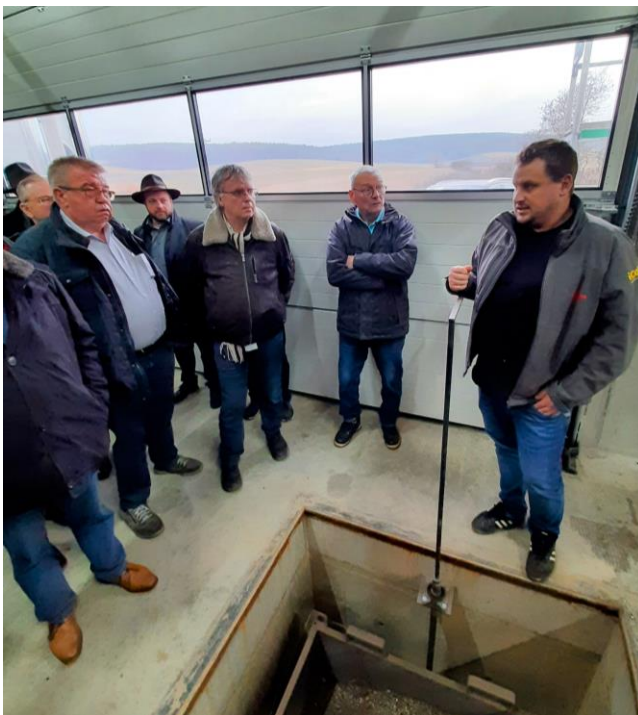
Abbildung 1: Julian Lörzel erläutert der Lenkungsgruppe in der Heizzentrale die Aschegrube des Hackschnittel-Kessels (Foto: Johannes Föhr)
