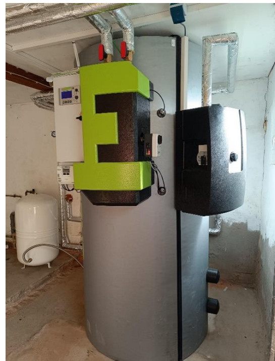
Abbildung 2: smarte Wärmeübergabestation auf Kundenseite (Fotos ff.: Nahwärme Waldbehörden e.G.)
