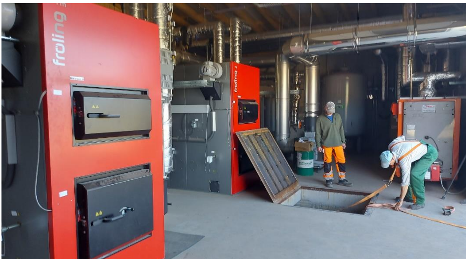
Abbildung 4: Hackschnitzel-Heizkessel der Fa. Fröling und geöffnete Aschegrube
